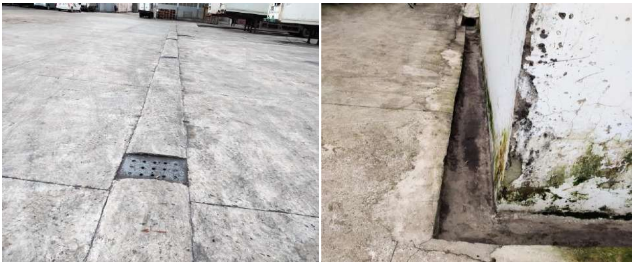
Hình 6. Công trình thu gom và thoát nước mưa
